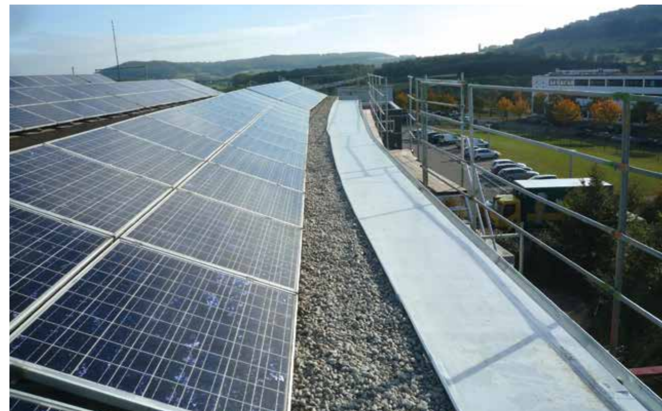
Photovoltaik-Anlage auf dem Dach des Verwaltungsgebäudes OIKOPOLIS I
