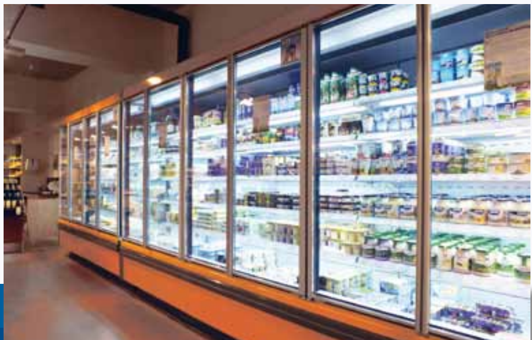
Geschlossene Kühlmöbel wie hier in der Filiale Munsbach sind bei NATURATA längst Standard. An den Scheiben angebrachte Infoblätter erklären die Bedeutung einer nicht unterbrochenen Kühlkette.
